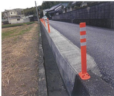
高知県高知市 転落防止（用水路）
