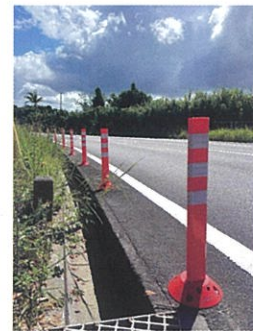
沖縄県今帰仁村 転落防止（側溝）
